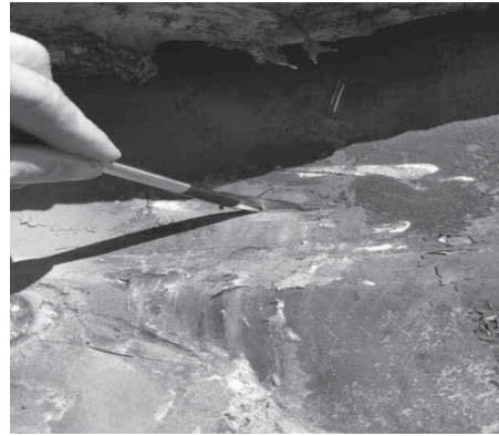
Gouge Removes Metal
